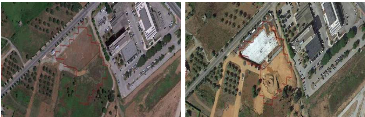
Figura 102 - Cantiere per una nuova costruzione a Lamezia Terme (CZ). Nel Comune sono stati consumati 3 ettari di suolo, per la realizzazione di nuovi edifici per l'agricoltura e per nuove costruzioni residenziali o commerciali.
