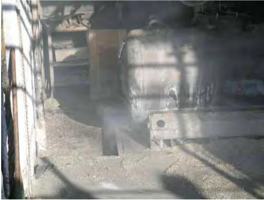
Foto n. 7 – Gas tossici e prodotti di combustione fuoriescono dal vano sottostante la bascula, durante le fasi della bonifica
