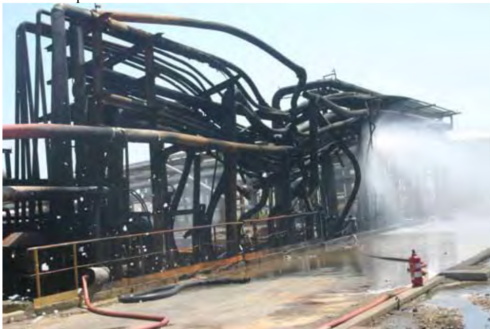
Foto n. 5 : Fascio tubiero a valle della strada –si noti la tubazione antincendio tra quelle danneggiate
