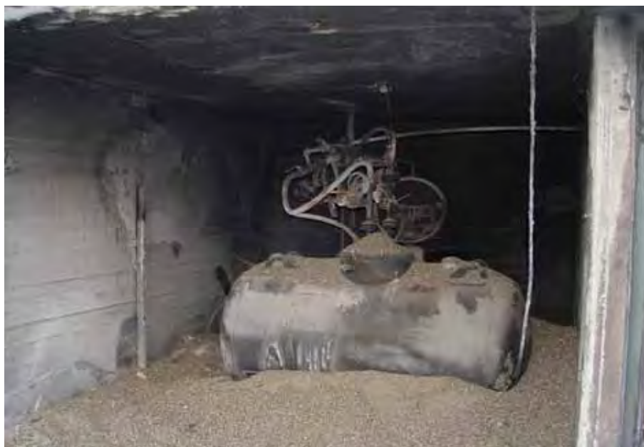
Foto n. 4 – Il contenitore di DEAC nel box danneggiato dall'incendio; è visibile la vermiculite usata per l'estinzione
