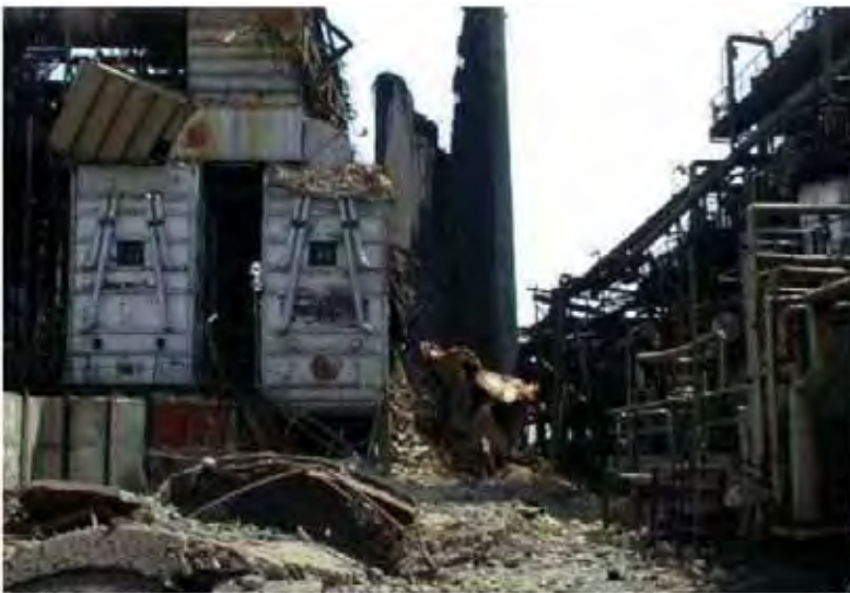
Figura 11 - Terremoto Kocaeli – Turchia del 17/08/1999. Raffineria Tupras di Izmit. Incendio impianto topping
