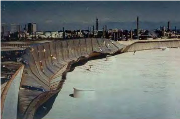
Figura 7 – Danni alla copertura di un serbatoio
