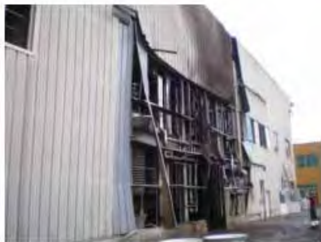
Figura 3. esterno del reparto dopo l'esplosione
