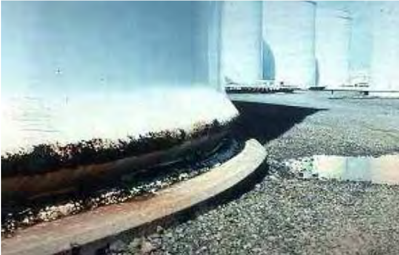
Figura 6 – danneggiamento serbatoio a “piede di elefante”
