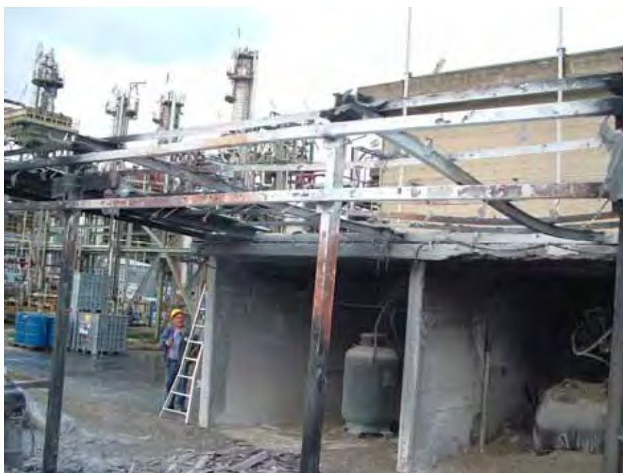
Foto n. 3 – Il box in calcestruzzo; nel vano a destra è visibile il contenitore di DEAC danneggiato dal fuoco
