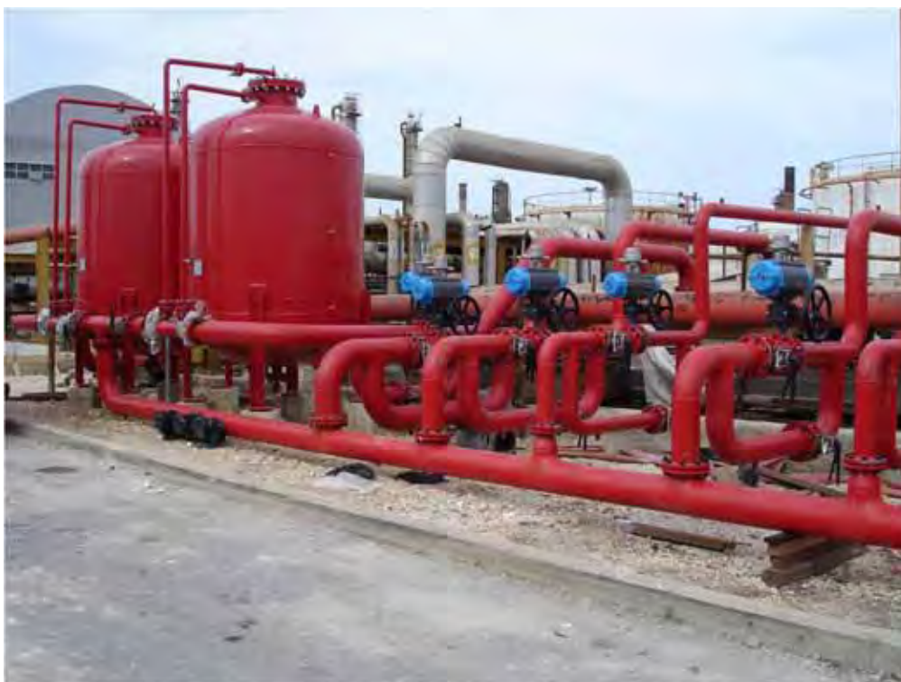
Foto n. 14 – Particolare delle centraline schiumogeno e delle connessioni con il nuovo impianto antincendio a protezione del sottopasso
