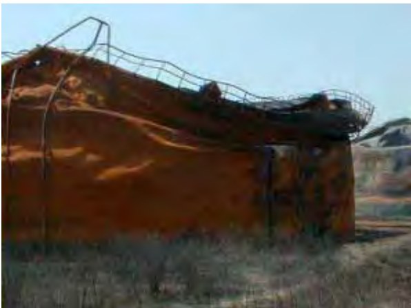
Figura 9 - Terremoto Kocaeli (Turchia) del 1999 - raffineria Yarimca
