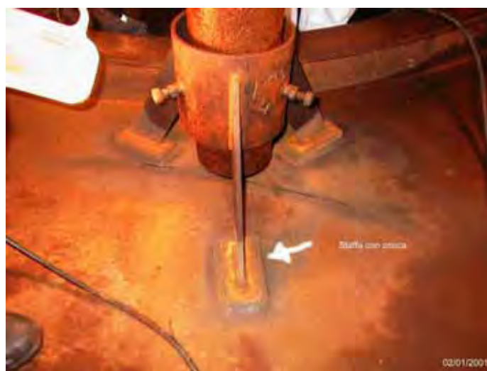
Fotografia n° 3 – Particolare cricca dall'interno del serbatoio
