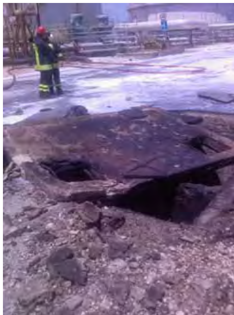
Copertura di uno dei pozzetti sollevata a causa dell'esplosione interna
