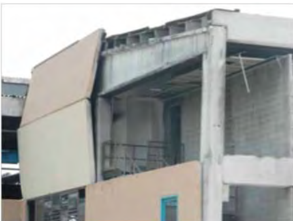
Figura 10 – Distacco dei pannelli di tamponatura
