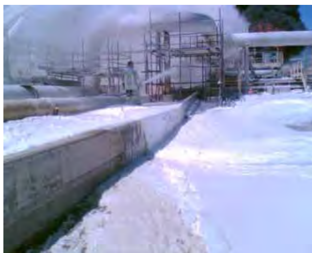
Utilizzo di schiuma da lance manuali per estinzione progressiva delle vasche
