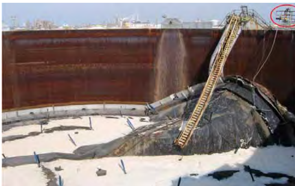
Fig. 2 Stato del tetto del serbatoio DA1305
