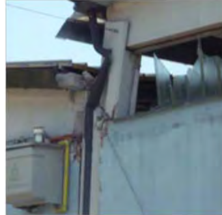
Figura 7 – danni alle colonne
