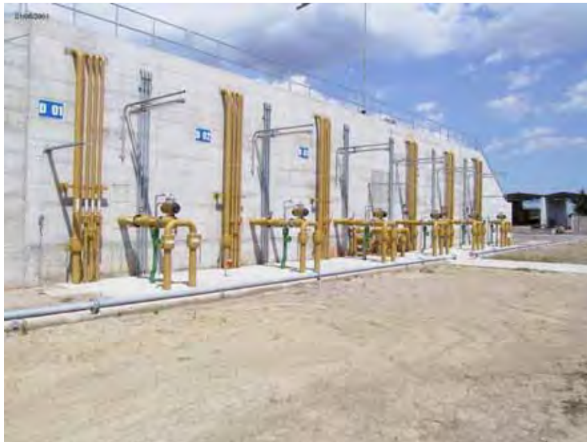
Fotografia n° 2 – Tumulo e tubazioni zona stoccaggio
