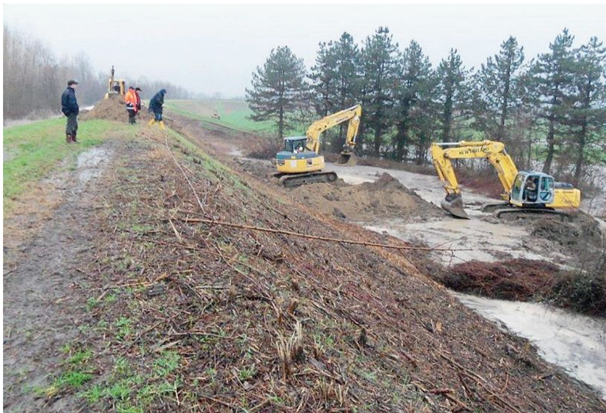
■ In foto, le ruspe che domenica 19 gennaio hanno chiuso una delle due falle che aperte sull'argine del Panaro, in località Saliceto. «Ci dicevano: andate via, qui si rompe come il Secchia» raccontano i residenti della zona. Nelle stesse ore la rottura dell'argine del Secchia a San Matteo causava il disastro nella Bassa ■ SERVIZIO ALLE PAG. 2 E 3
